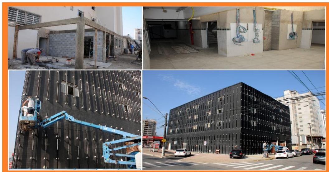
Construção do novo Pronto Socorro Central do Complexo Hospitalar Irmã Dulce. Fonte: SESAP 10.3.
